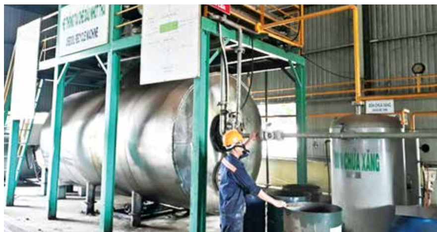
Hệ thống xử lý dầu nhờn thải
