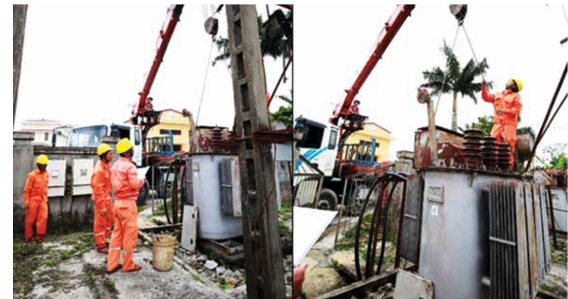
Công ty Điện lực Hà Nam diễn tập xử lý sự cố
