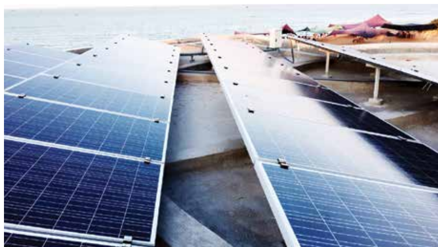
Hệ thống điện mặt trời tương tác lưới được xây dựng tại tuyến phố đi bộ ven biển TP Tuy Hòa, Phú Yên.
